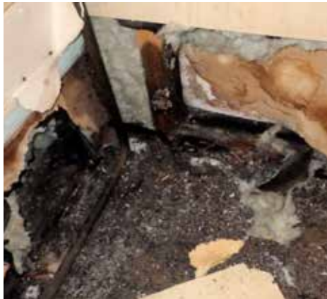
Ulkoseinän vaurioituneita rakenteita. Lisätutkimus asuntokaupan jälkeen.
