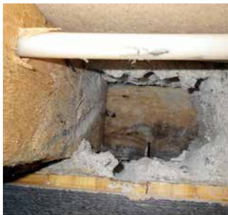
Väliseinän alaohjauspuu on betonin sisällä ja puu on vaurioitunut.
