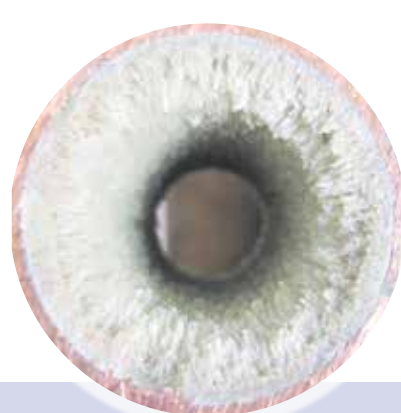
Kalkkikerrostumaa lämpimän käyttöveden putkessa.
