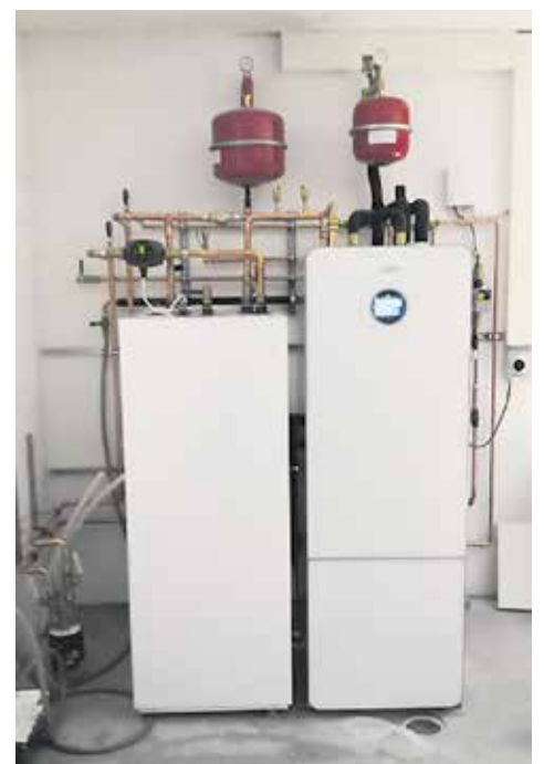
Boschin uusi invertterimaalämpöpumppu muutti uuteen kotiin. Kuva: JH Lämpö Oy.
