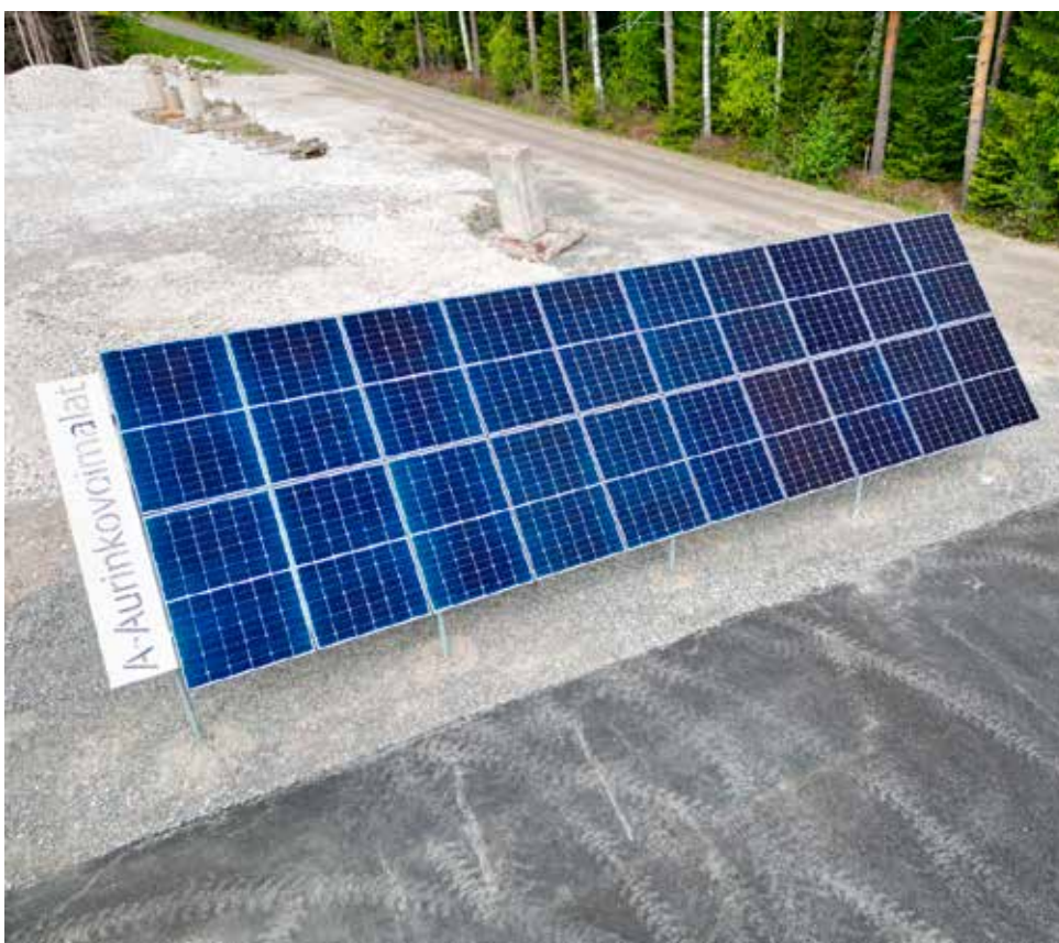
Uutena tuote- ja palvelukonseptina on aurinkopaneelientien maa-asennukset.
