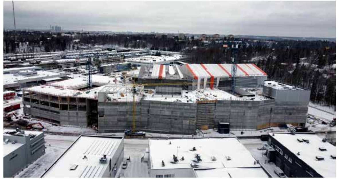
Itä-Helsingin Roihupeltoon entiselle teollisuusalueelle rakenteilla oleva Stadin ammatti- ja aikuisopiston kampus otetaan käyttöön 2026. Kuva: Lujatalo
