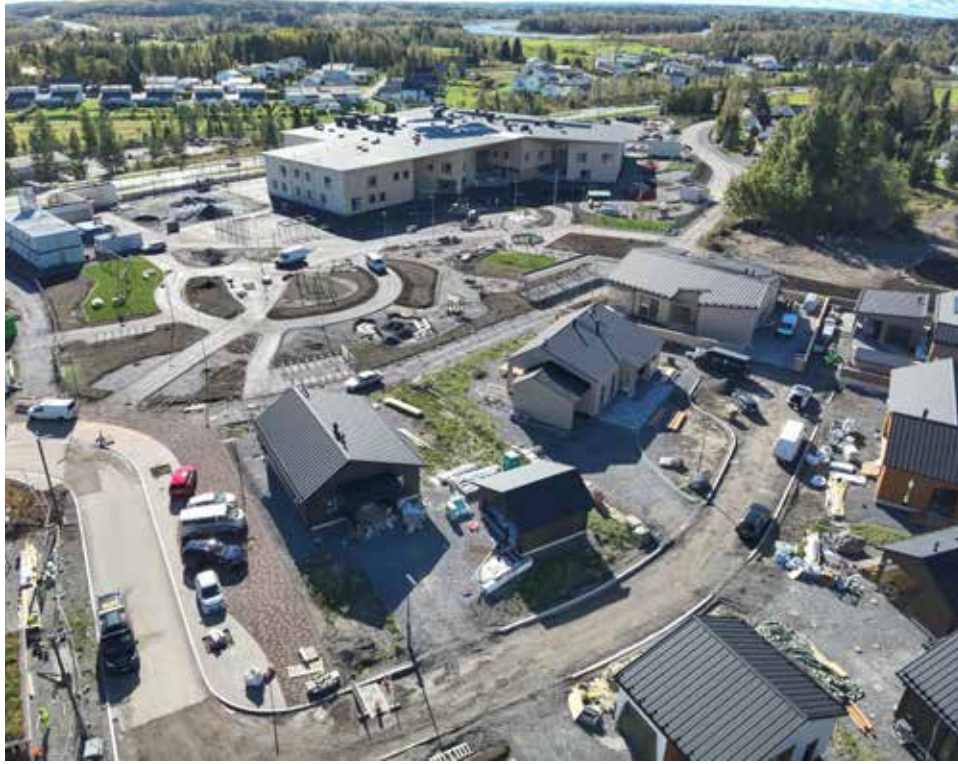
Saikkaan rakennetaan 19 omakotitaloa, 2 paritaloa, 2 rivitaloa, 1 kaupunkipiennä, 1 kerrostalo sekä Saikantalo, jossa tulee toimimaan alueen päiväkotij ja alakoulu. Kuvapalvelu Salopino
