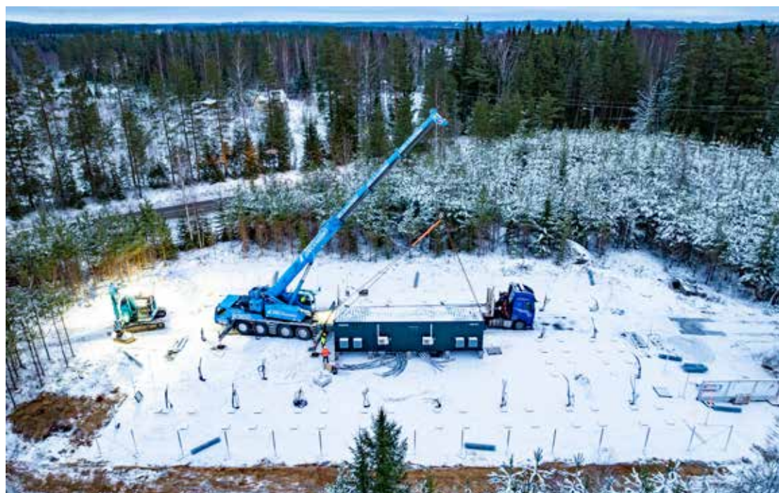
Kuhmoisiin rakentuva akkupuisto on määrä saada kaupalliseen käyttöön tammikuun loppuun mennessä. Kuva: Mikko Kankainen
