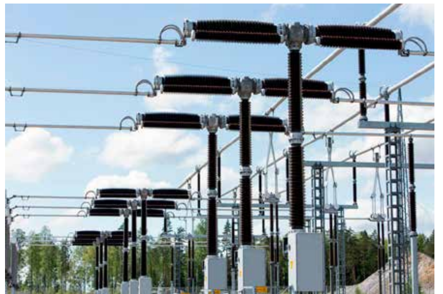
Sähköasema. Kuva Fingrid Oyj
