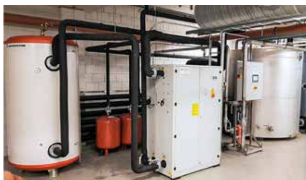
Jäteveden LTO-laitteisto teollisuuskohteessa.
